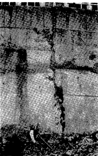
写真一5 コンクリート護岸のくい違い破壊（右ずれ, 地点No.9）
