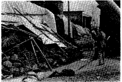
写真一4 玉石空積擁壁の崩壊（地点No.5'）
