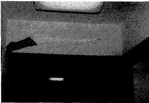
写真-13 梁のせん断ひび割れ
