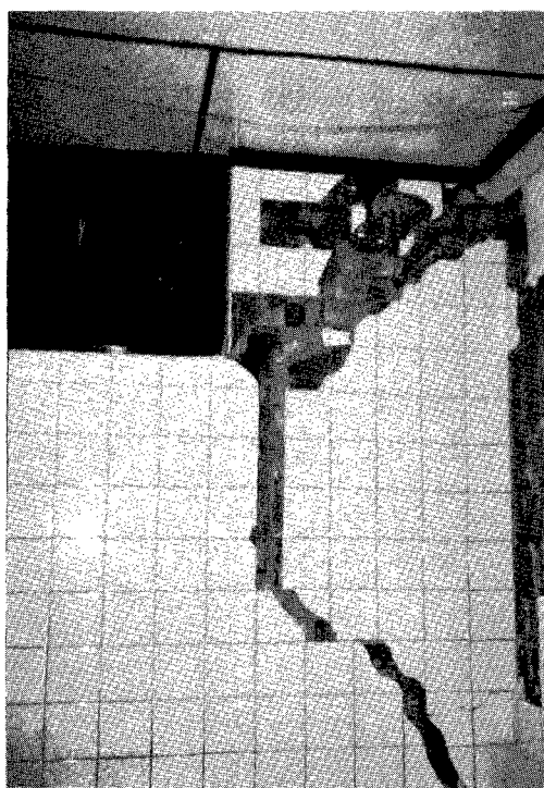
写真-4 けた行き方向レンガ壁のせん断破壊
