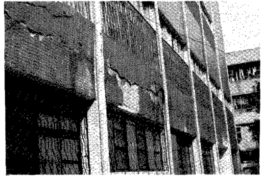
写真-23 スラブ打ち継ぎ面のせん断ズレ
