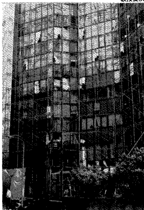
写真-7 破壊した側の外観
