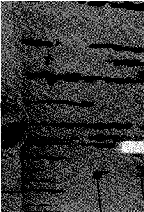
写真-19 スラブ下端。かぶり不足。
