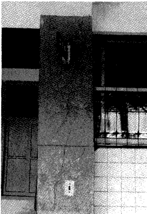
写真-24 柱のせん断ひび割れ。一方向のみのひび割れ
