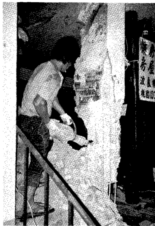
写真-2 はつり中のせん断破壊柱
