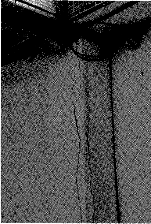
写真-18 柱の割裂破壊
