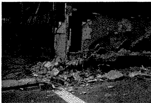
写真-8 耐震壁脚部の破壊 (台湾大学 蔡, 邱 教授提供)
