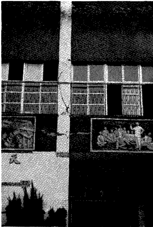
写真-22 柱のせん断。スラブ打ち継ぎ面のズレが柱を貫通
