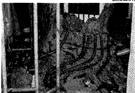
写真-9 耐震壁柱の圧壊の状況
