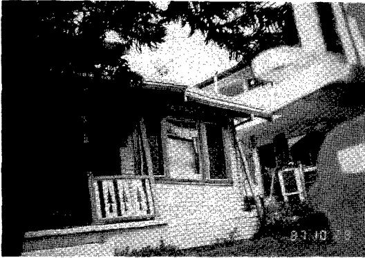
写真-1 ウイットティア市の木造住宅の被害
