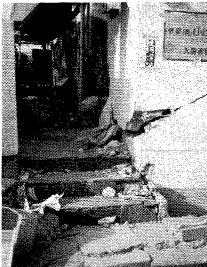
写真4 1階部分の崩壊
