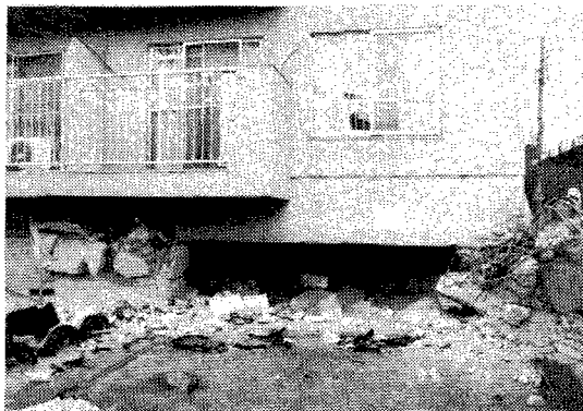
写真2 1階ピロティー部分の崩壊
