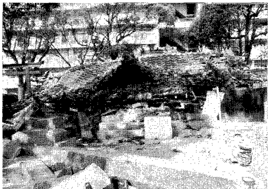
写真1 木造の倒壊 (旧くかつ重いかわら屋根)
