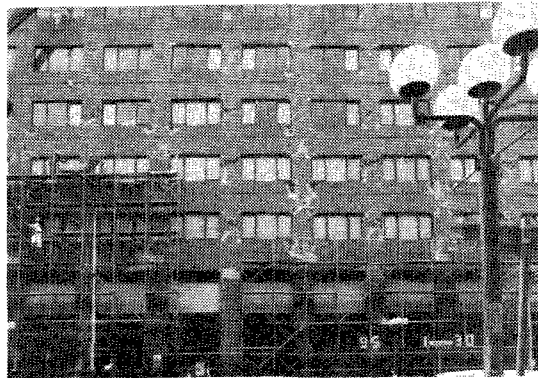
写真8 柱梁接合部のせん断破壊
