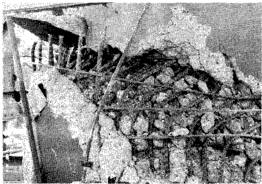
写真9 柱主筋ガス圧接部の破断
