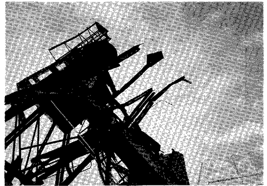
写真2 塔形ジブクレーンの落壊
